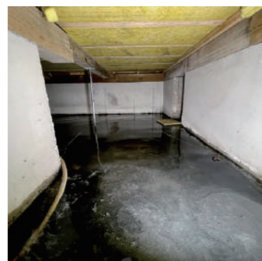
汚水の蓄積により基礎コンクリートの表面はカビで黒く変色している。
