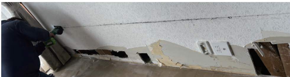
浸水から1ヶ月経過した住宅。表面にカビが発生し、中の断熱材は大量の汚水を含んでいます。
